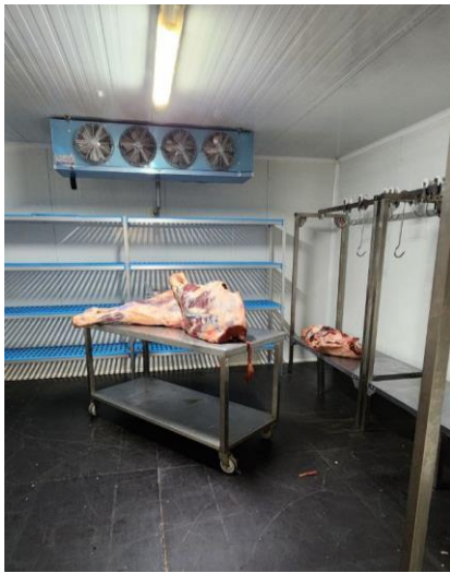
Figure 11 chambre froide viande rouge
