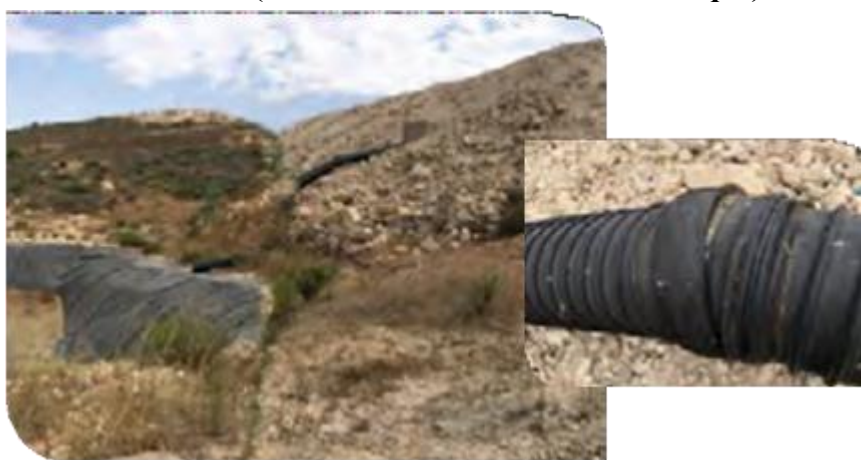
Photo 7 : Anomalies de réalisation ; raccordement de collecteurs des lixiviats non conformes (en utilisant fils d'attache métallique).
