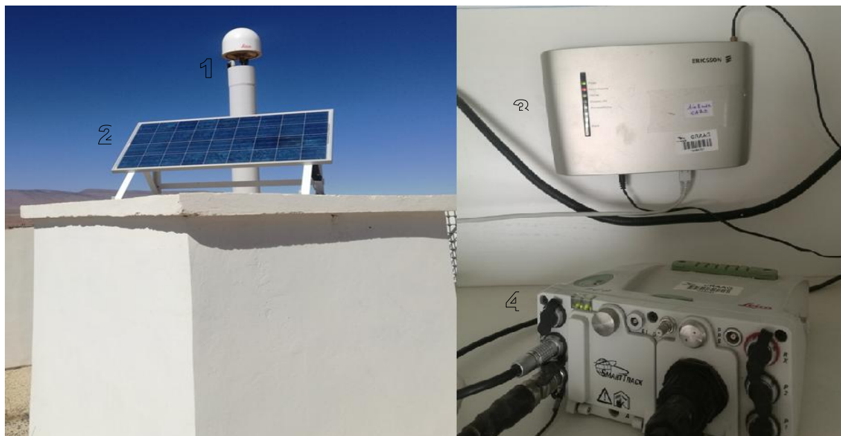
Figure 6 : Exemple d'une station : 1– Antenne, 2 – Panneau solaire, 3 – Routeur GSM et 4 – Récepteur GNSS.
