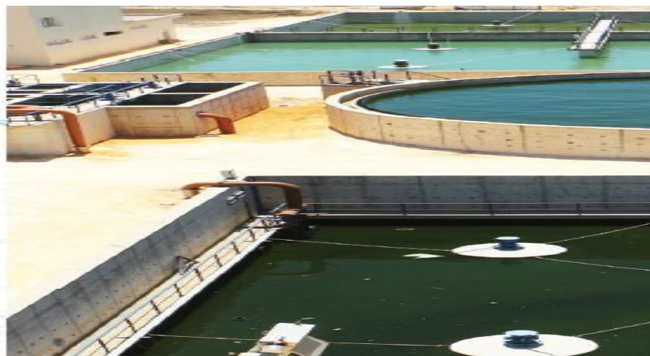
Figure 12 – Station de traitement des eaux usées
