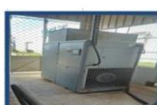
COMPRESSEUR GA45 : air comprimé
