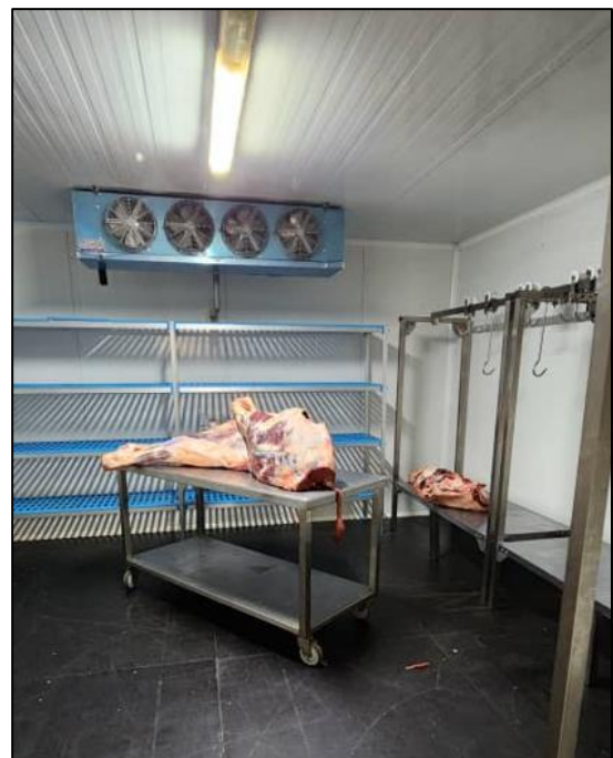
Chambre froide de viande
